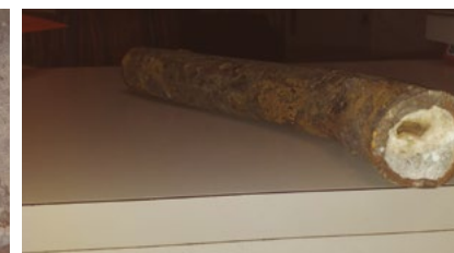
Tuyau d'eau obstrué par du calcaire
